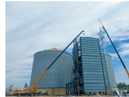
水泥平底仓 Cement flat bottom silo
